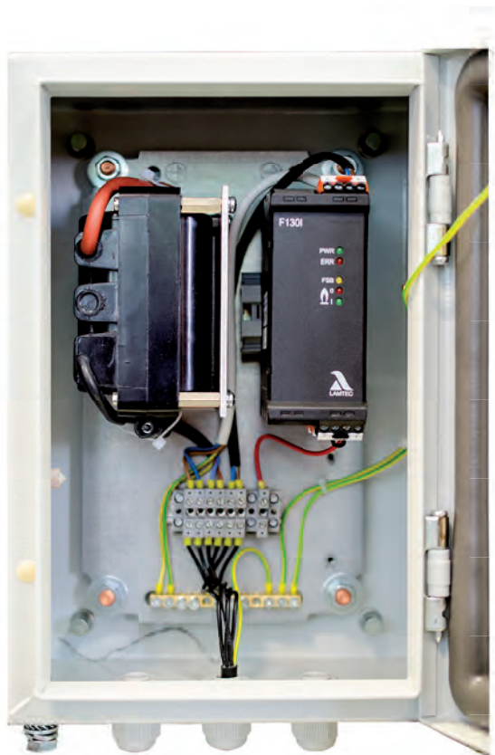
Fig. 3-30 Unidade de potência externa para área segura
