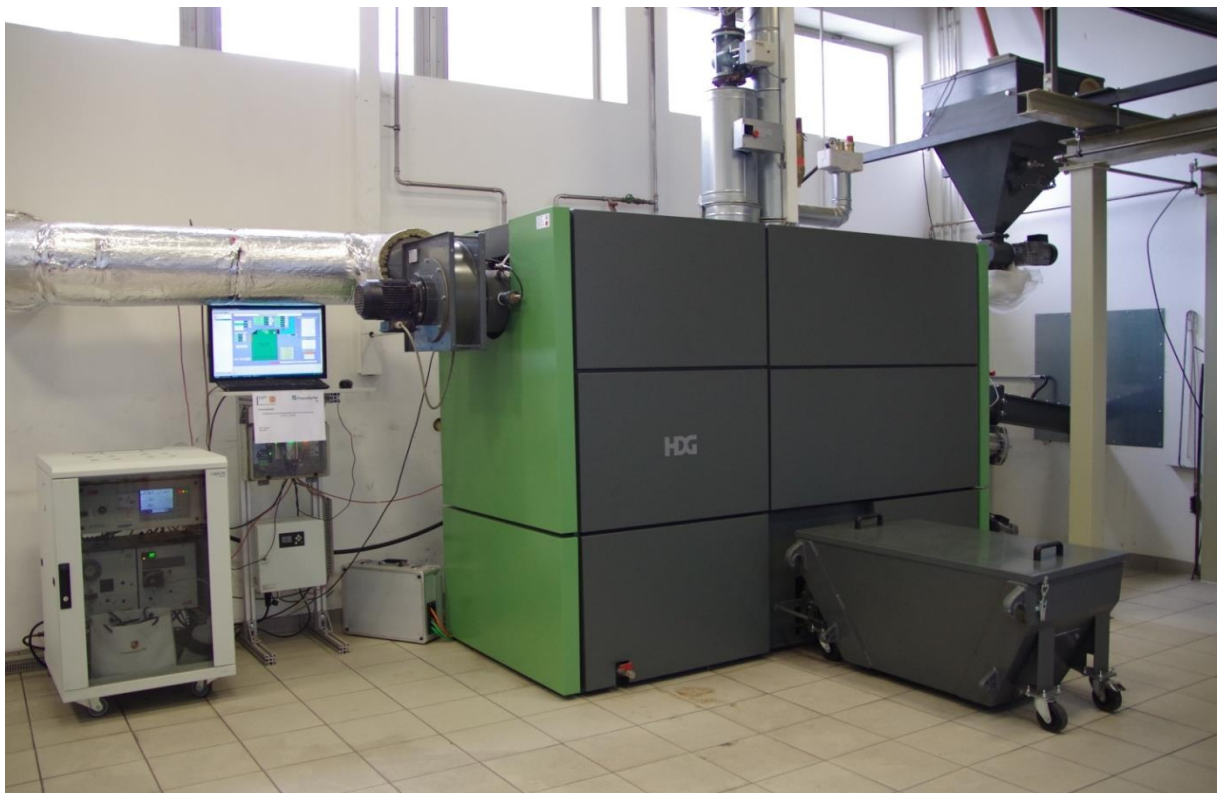
Abbildung 13: Automatisch beschickter Heizkessel der Firma HDG (Typ HDG M).
