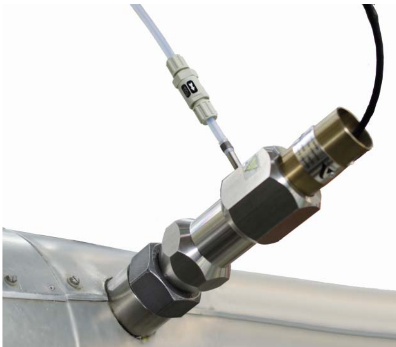
Fig. 7-2 Prüfvorrichtung im Abgaskanal eingesteckt
