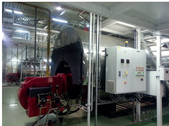
Bild 6. Auf \text{CO}_e/\text{O}_2 -Optimierung umgebauter 5 MW Zweistoffbrenner mit LT3F-Sensorelektronik sowie Schaltschrank mit integrierter BT300, Drehzahlregelung etc.
