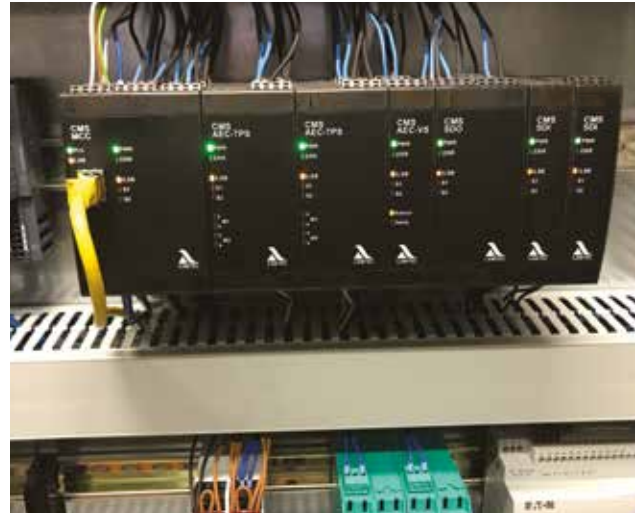
Modules CMS montés dans l'armoire de commande.
