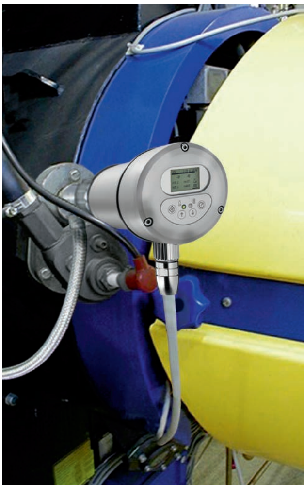
Skaner płomienia F300K firmy LAMTEC w użyciu..
